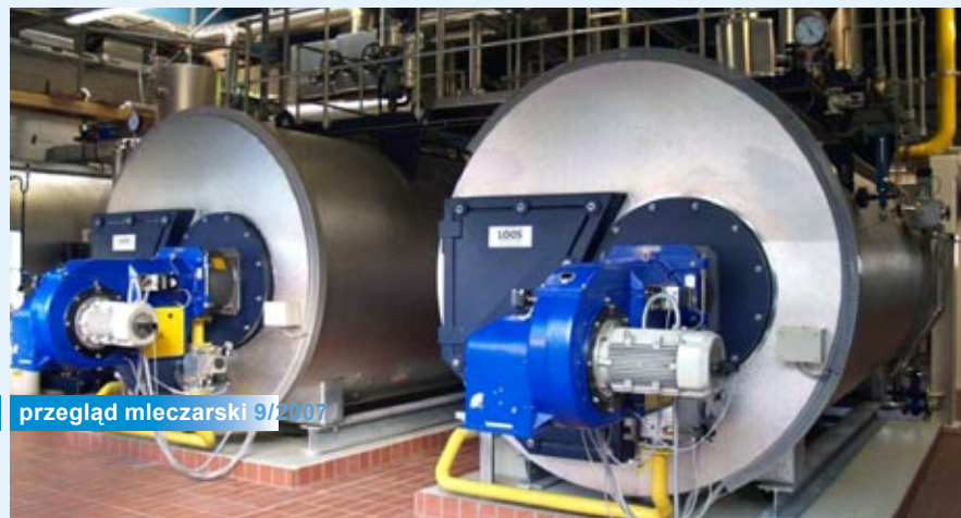
Rys.1 Nowoczesna kotłownia parowa LOOS
