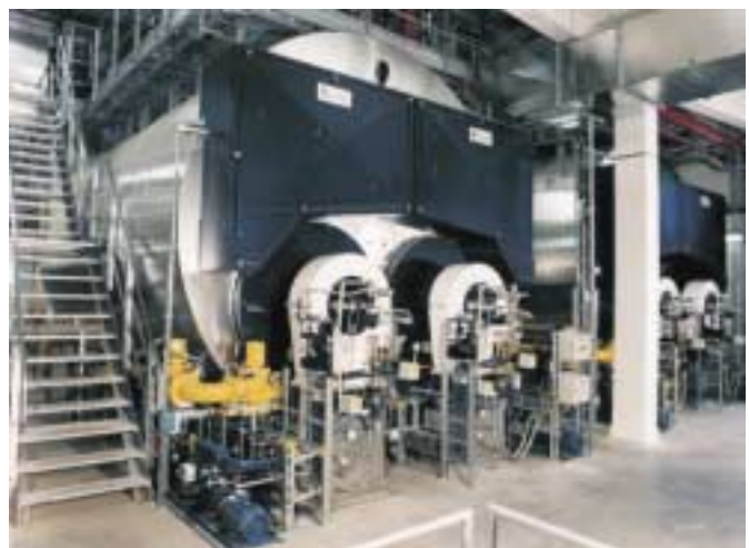
4 kotły wodne wysokotemperaturowe dwupłomienicowe UNIMAT UT-HZ zainstalowane w jednej kotłowni. Każdy o mocy 23 000 kW.
